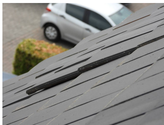
Overzicht dakvlak met verschuiving
