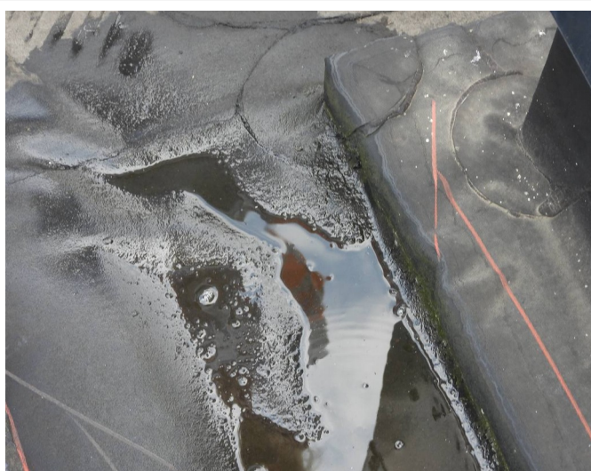
Stilstaand water in scheur EPDM
