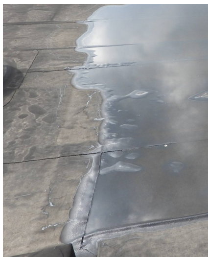
Blaasvorming zichtbaar via wateroppervlak
