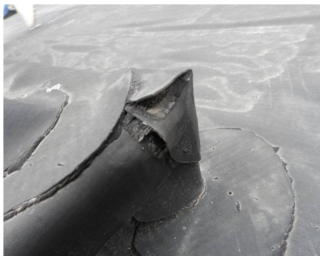
Scheur in EPDM bij opstand
