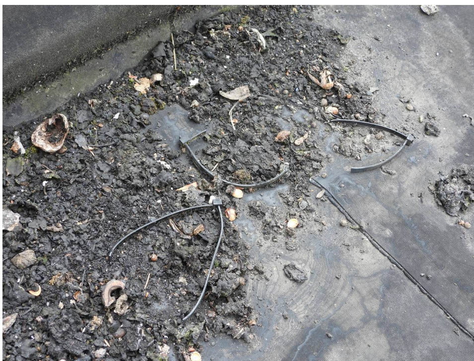
Losse kabelbinders op het EPDM
